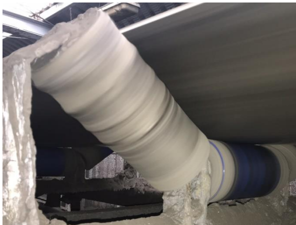
Bild 7: Verstärkte Materialanbackungen an einer Stahlrolle
